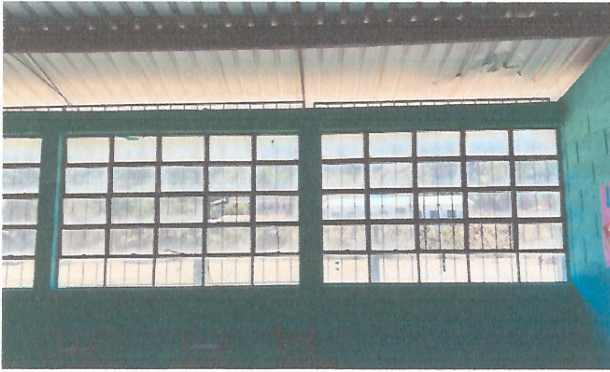
Foto 1: Cubierto de Lamina
